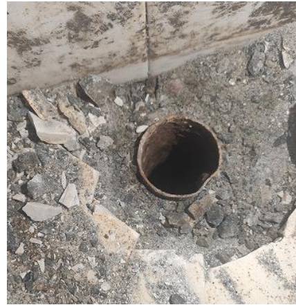
图 2 燃气套管被埋在装修层下方
